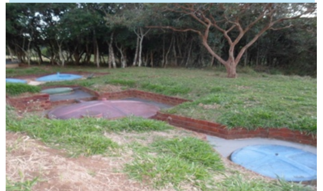
Estação de tratamento. Fotografia Monisa Lopes
